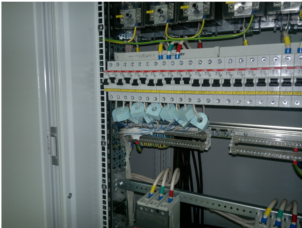
Рис.1. Подключение трансформаторов к силовым фидерам питания стоек
